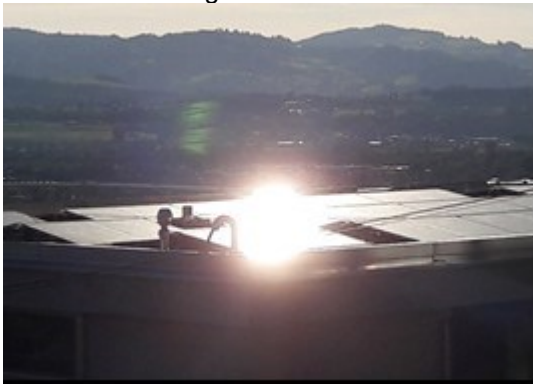
Abbildung 11: Beispiel der Blendwirkung einer PV-Anlage auf einem Flachdach. Die Solarmodule sind in diesem Fall mit leichter Neigung ungefähr nach Osten und Westen ausgerichtet.
